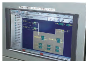
大学建物の中央監視装置
