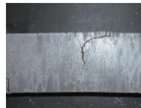
コンクリートに発生するひび割れ
