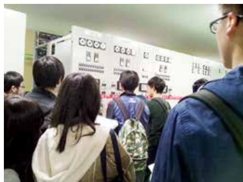
1年生学外研修での変電所見学
