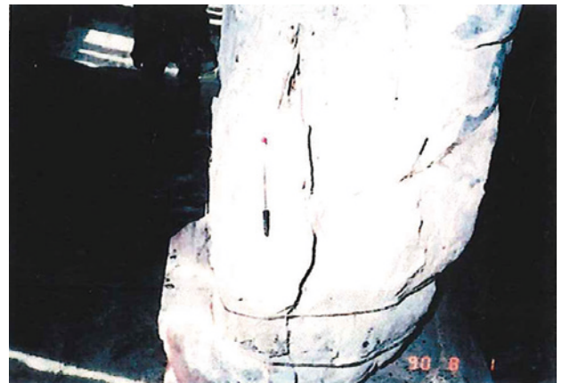
写真-9 石柱の亀裂とクラック
