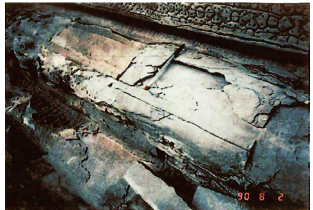
写真-8 砂岩の剥離
